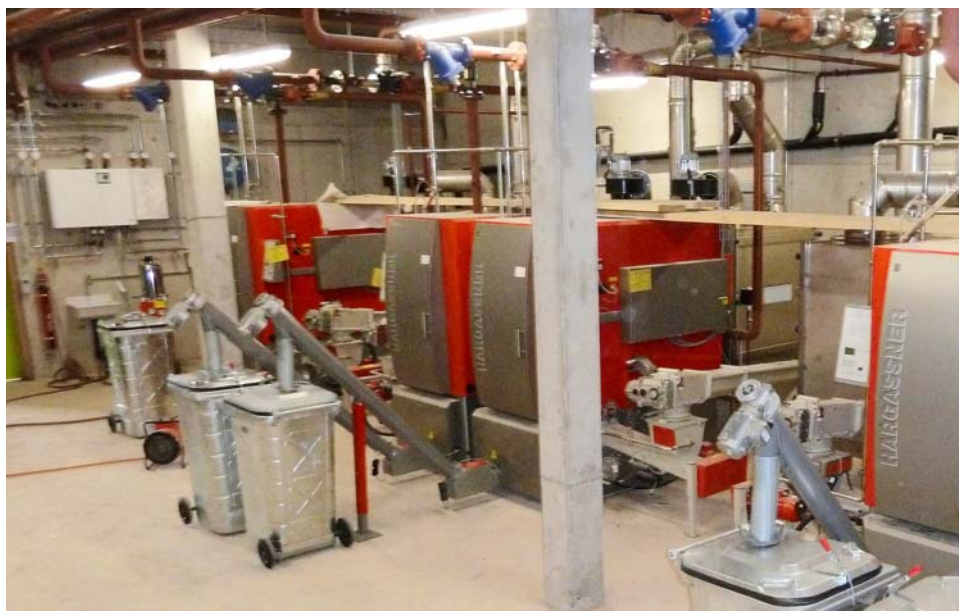
Die Heizzentrale der Fernheizung von Beringen mit fünf Heizkesseln. (Foto: Heitzmann AG)
