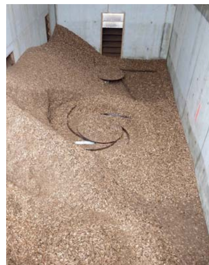
Einblick in das Holzschnitzel-Silo: Die Federkernaustragungen mit je 5 m Durchmesser sorgen für den Nachschub an Brennmaterial, welches mittels Förderschnecken in die Heizkessel transportiert wird. (Foto: Heitzmann AG)
