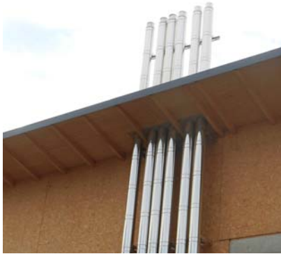
Die Kaminanlage der Fernheizung. Das Mehrkesselprinzip sorgt für einen optimalen Feuerungsbetrieb und kann dadurch den Ausstoss an Schadstoffen massiv reduzieren. (Foto: Andreas Widmer)
