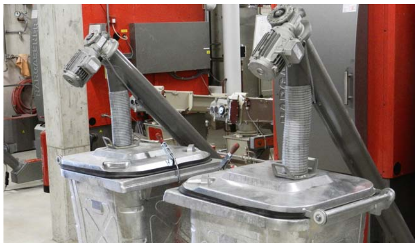
Die Asche wird automatisch in Container geführt und kann dadurch bequem entsorgt werden. Der hohe Automationsgrad der Anlage erlaubt einen zuverlässigen Betrieb. (Foto: Andreas Widmer)
