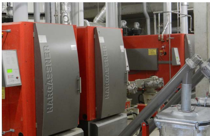
Die einzelnen Heizkessel mit je 200 kW werden durch eine Kaskadenregelung nach Leistungsbedarf zugeschaltet. (Foto: Andreas Widmer)
